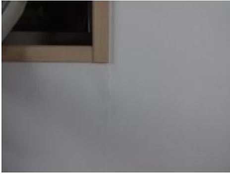
図 3-3 加振後の状況（耐震）
