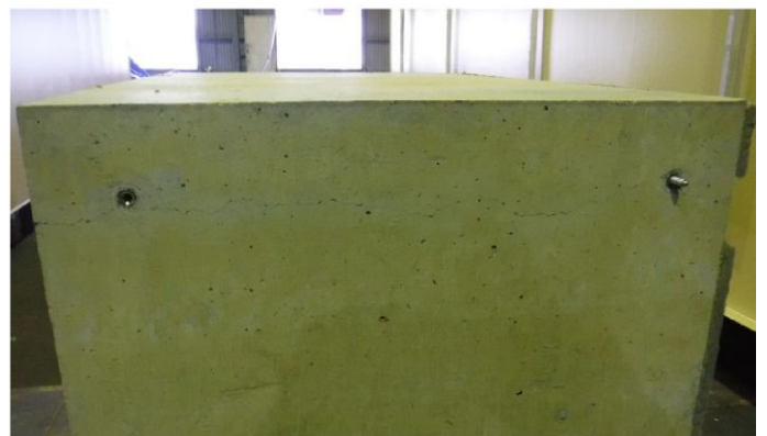
図7 カルバート亀裂状況
